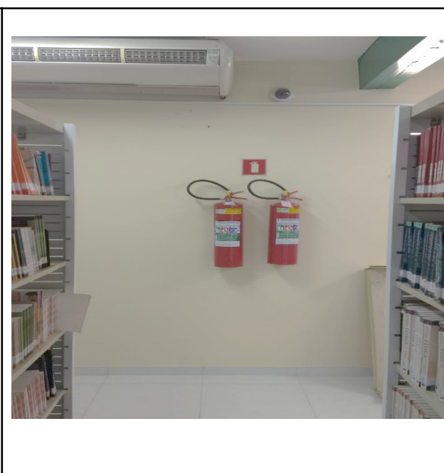
Ausência de marcação no piso para destacar os extintores de incêndio em 18.10.2019.
